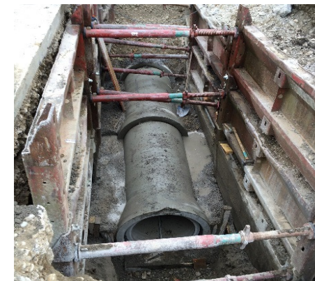
Fachgerechte Spreissung, Centub-Rohr \varnothing 800\text{mm}
